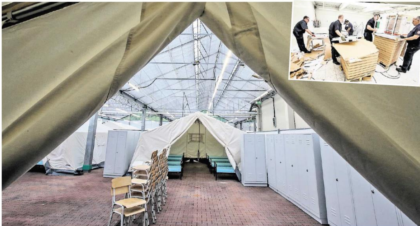
Neue Heizung, neue Wasserleitungen, neue Sprinkleranlage: In nur vier Wochen hat die Feuerwehr den alten Baumarkt in eine Unterkunft verwandelt.
